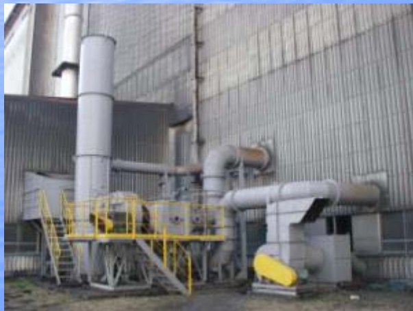
NYB 屋外排気設備 施工3年後
