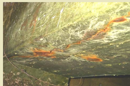
写真3 フープ筋膨張による梁のコンクリートの亀裂
