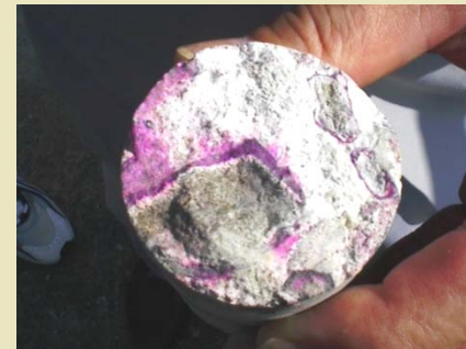
写真2 アルカリ骨材反応による 黒色環(リム)の発生
