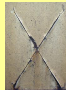
スラグリードSR-2 劣化
