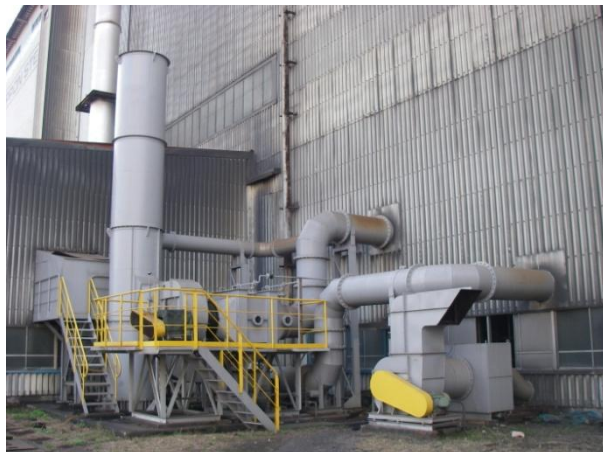
屋外排気設備 施工3年後
