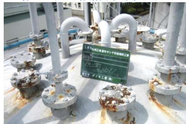
工場内プラント設備(半年経過)
